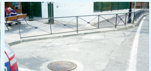
Prolongación de acera en la zona del Colegio y colocación de vallado de seguridad
